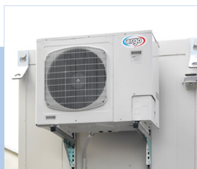
Climatisations split avec groupes frigorifiques (vue extérieure)
