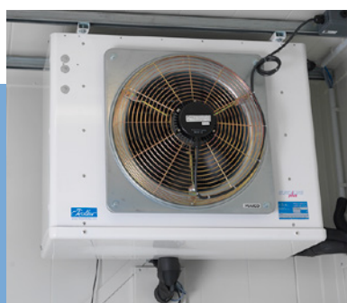
Climatisations split avec groupes frigorifiques (vue intérieure)
