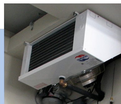
Climatisations split avec groupes frigorifiques (vue intérieure) en version ATEX
